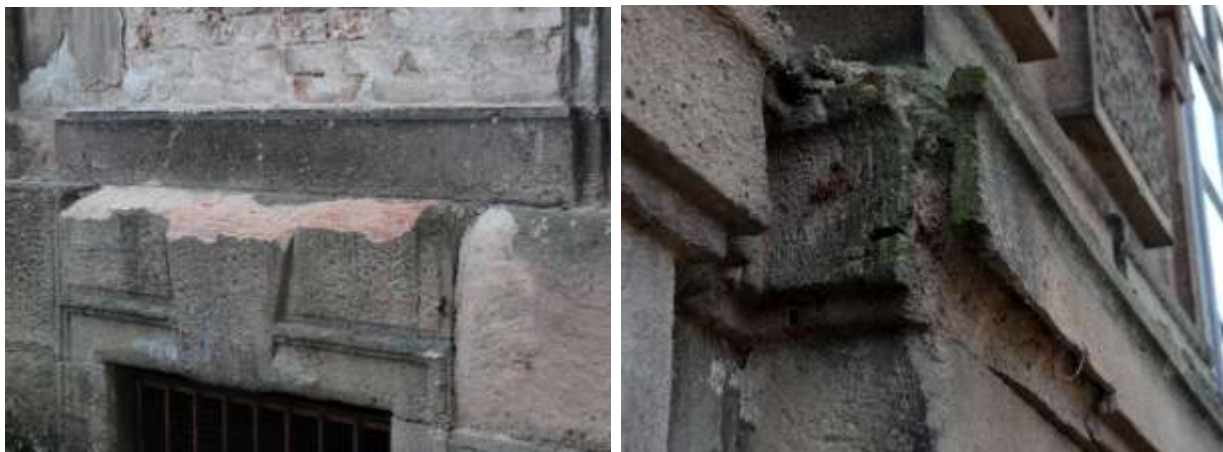
Obrázek 2 a 3: Ukázka typického poškození kamenných prvků SZ a JZ fasády prelatury
