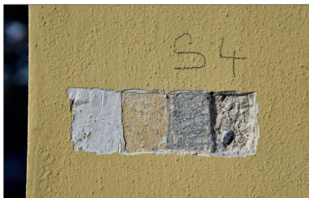
Obr. 3. Sondážní odkrytí starších povrchů, které dává základní představu o postupných proměnách fasády i o rozsahu dochování starších úprav, je důležitým předpokladem pro odběr vzorků určených pro laboratorní průzkum.
